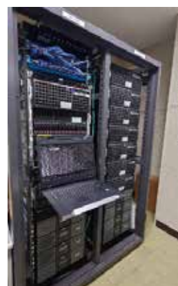
サーバ室に設置された計算機システム
